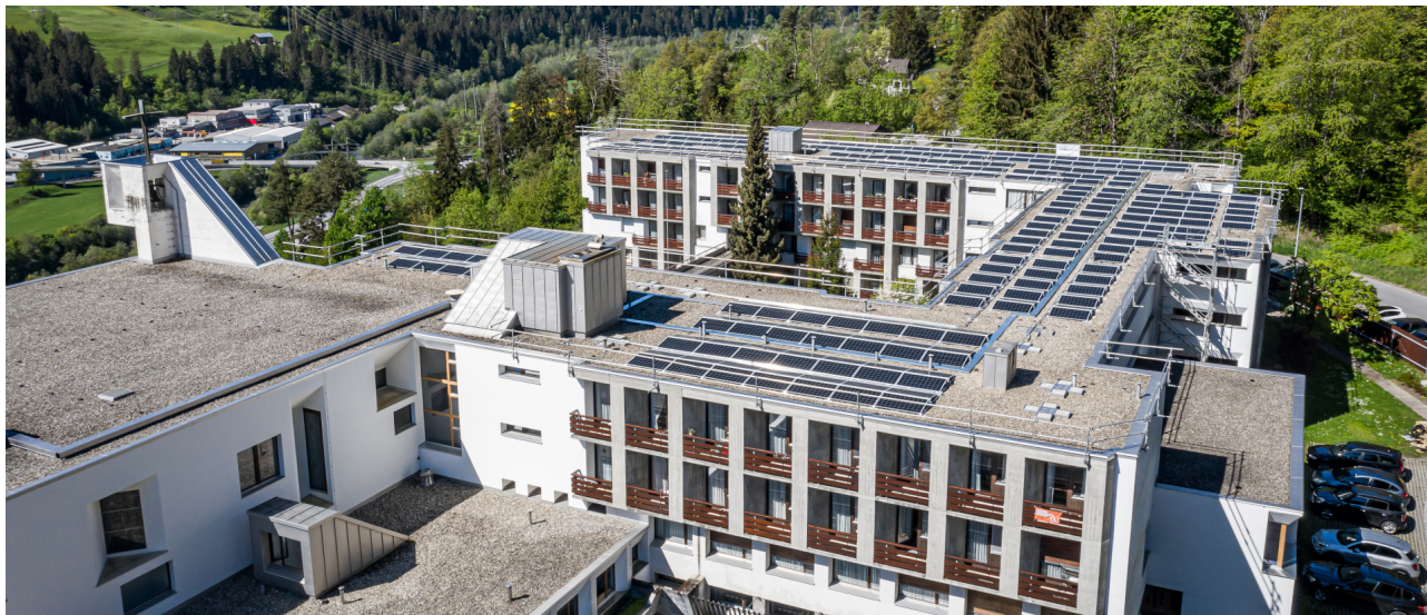
Photovoltaik-Solaranlage auf dem Dach des Klosters Illanz.
